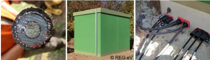
Bild: li. Kabel im Querschnitt; Übergabestation am Sportzentrum; re. Kabeleinführungen: je 3 Kabel links zum Trafo Sportzentrum, Mitte vom Windpark mit Leerrohr, rechts nach Roßdorf
